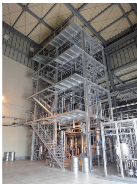
写真2 蒸留濃縮設備。モラセス（廃糖蜜）を発酵させて得たバイオエタノールを蒸留、濃縮して純度を高める。
